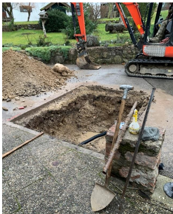
Ob kleine oder große Baustelle – unser Bauhof muss (meistens) mit Hand anlegen, wie hier bei der Behebung eines Wasserrohrbruchs.
